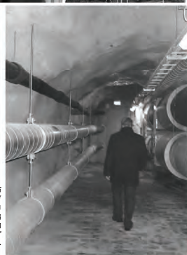
冷戦時代の地下防空壕を改造したデータセンター。コンピューターが出す熱を回収するパイプが縦横に走るヘルシンキ
